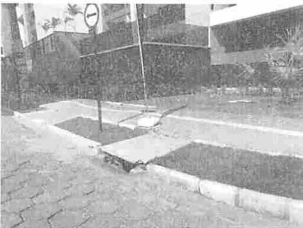
Foto 9 – Boca de lobo para captação e Drenagem da Av. Oceano Índico.
