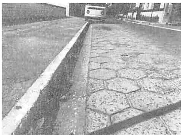
Foto 4 – Sarjeta existente na Av. Oceano Índico.
