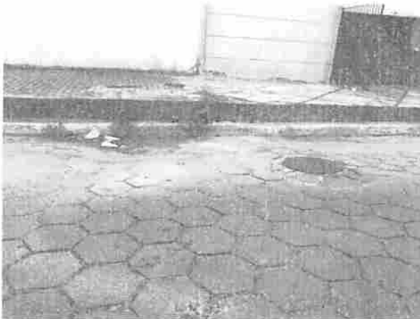
Foto 7 – Afundamento pontual de piso e Bueiros de esgoto.
