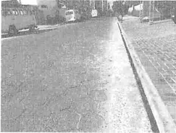
Foto 5 – Sarjeta existente na Av. Oceano Índico.
